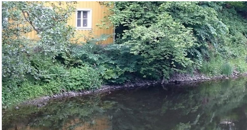
Figur 14. Del av befintligt erosionsskydd vid nedre Brobacken, fastigheten Dergården 1:11, strax nedströms Wamme bro (Bildkälla: COWI, 2014).
