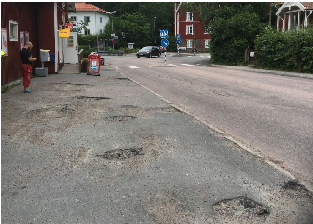
Figur 11. Potthål på gångbanan vid Tollereds ströms väg. Marken där gångbanan ligger ägs delvis av Lerums kommun. Foto ÅF 190627.
