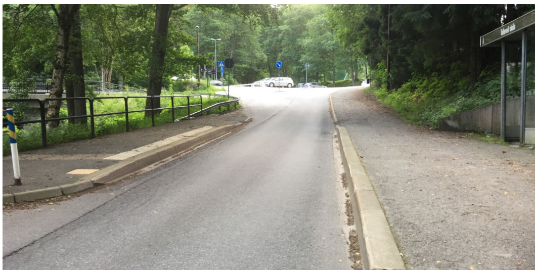
Figur 27. Busshållplats Tollered skola vid Tollered Ströms väg. Hållplatsläget till höger används inte, men det är på denna sida busskuren står (höger i bilden ovan). Reflexstolpar till vänster i bild har blivit nerkörda. Foto ÅF 190627.
